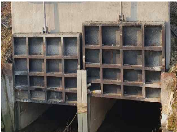
문짝 및 문틀 상태양호
